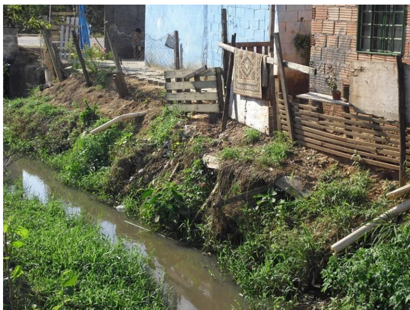
Foto 03 – Lançamento de esgoto “in natura” no córrego Mandi – Jardim Novo Horizonte.
