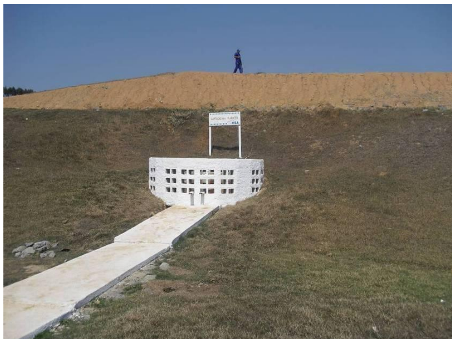
Foto 09 – Poço de Captação de Líquidos Percolados (Chorume).
