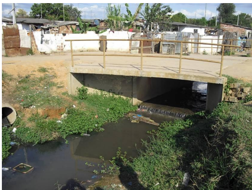
Foto 05 – Travessia 4 do córrego Mandi, com detalhe para o lançamento de esgoto na galeria de águas pluviais –Jardim Novo Horizonte.
