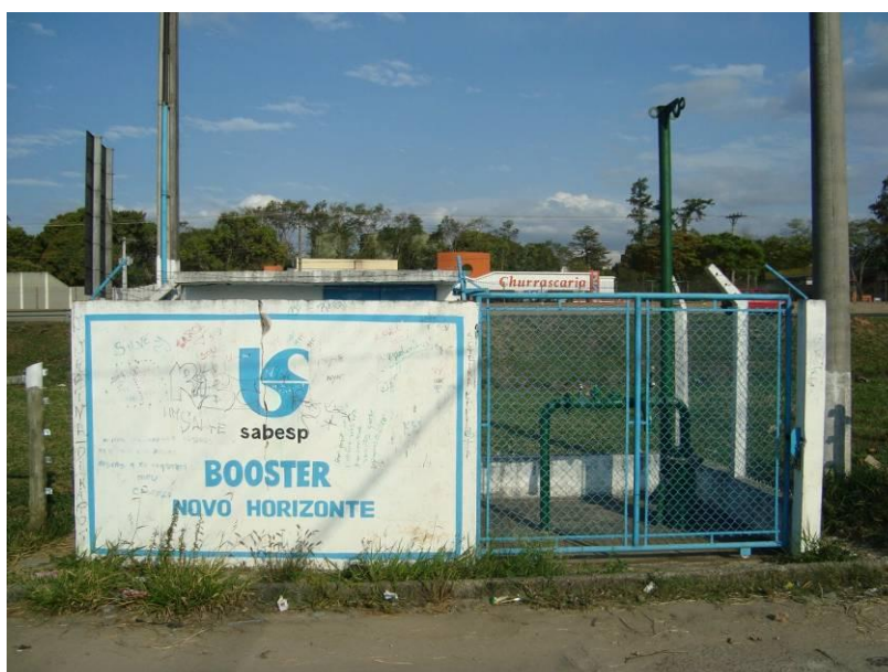
Foto 02 – Booster Novo Horizonte.
