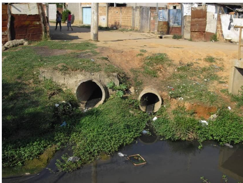
Foto 04 – Contribuições de esgoto nas galerias de águas pluviais.
