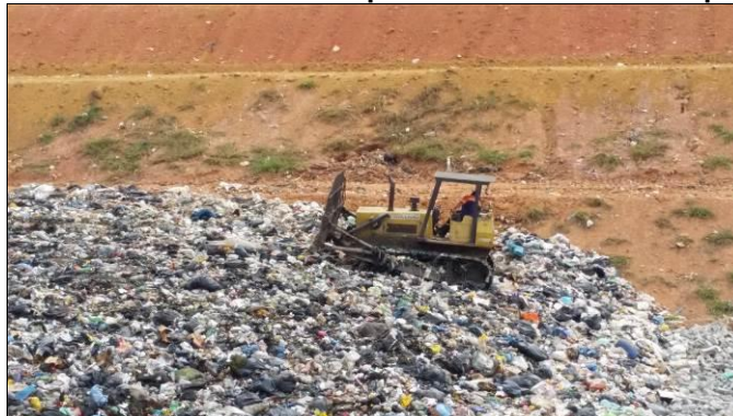
Figura 43: Resíduos sendo compactados na célula em operação.
