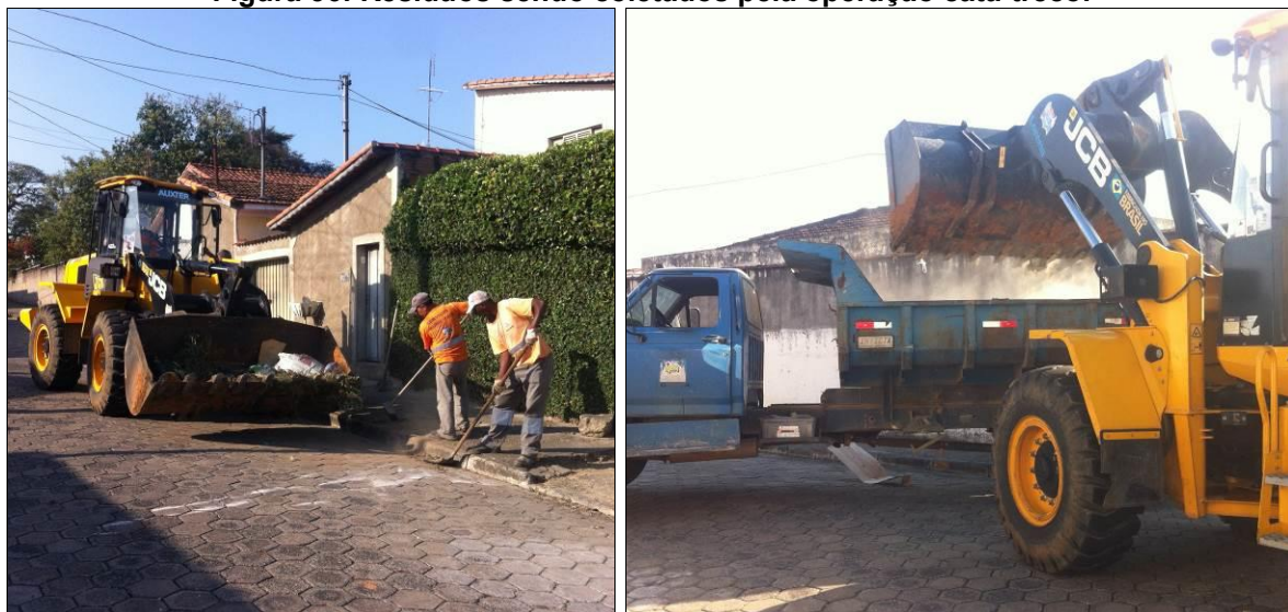
Figura 56: Resíduos sendo coletados pela operação cata-treco.
